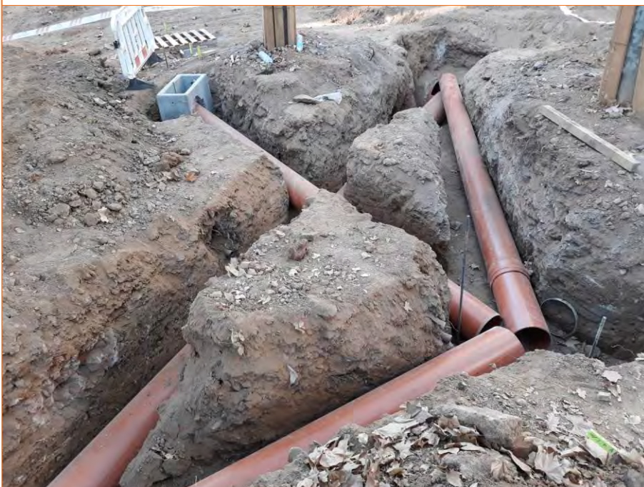
Foto 52. Vista de les rases dels embornals del carrer Rocafort.
